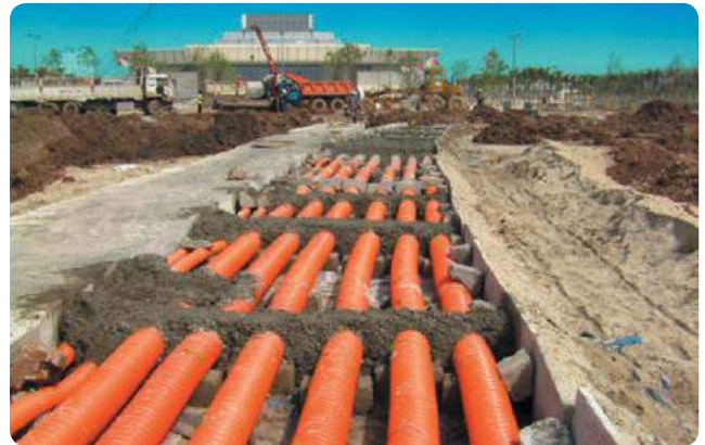
Hệ thống cáp ngầm tại các dự án đường dây cao thế 110kV - 220kV Underground cable system at 110kV - 220 kV power cable lines
